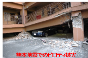
熊本地震でのピロティ被害
