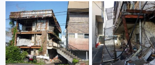
※管理不全マンションの事例（R2、行政代執行により除却）
