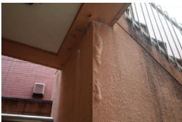
塗膜の浮き・剥がれ
