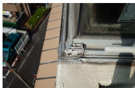
シーリングの著しい劣化
