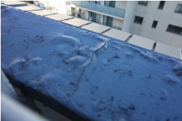
防水の下に雨水が侵入
