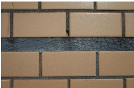
シーリングのひび割れ
