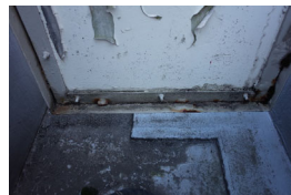
隔て板の劣化
