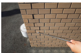
タイルのひび割れ・浮き
