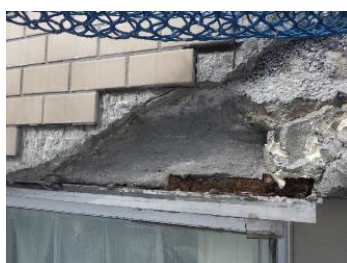
【改修前】躯体の劣化状況
