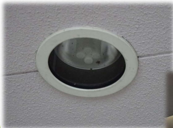
↑ * 共用廊下のダウンライト
