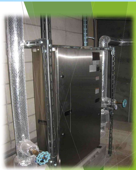
増圧直結給水ポンプ
