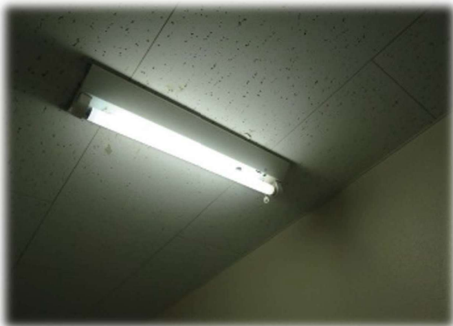
↑ * 非常用照明(常時点灯兼用／建築基準法)
