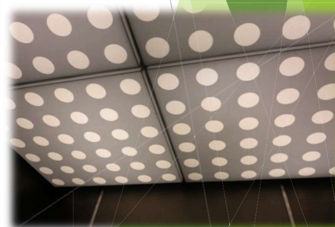
↑ * エレベーター籠内のLED化
