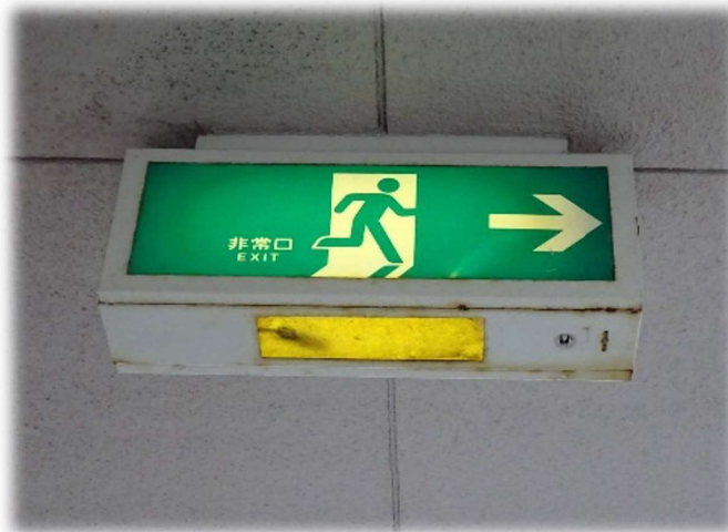
↓ * 24h点灯の誘導灯(消防法)
