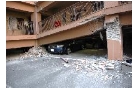
熊本地震でのピロティ被害
