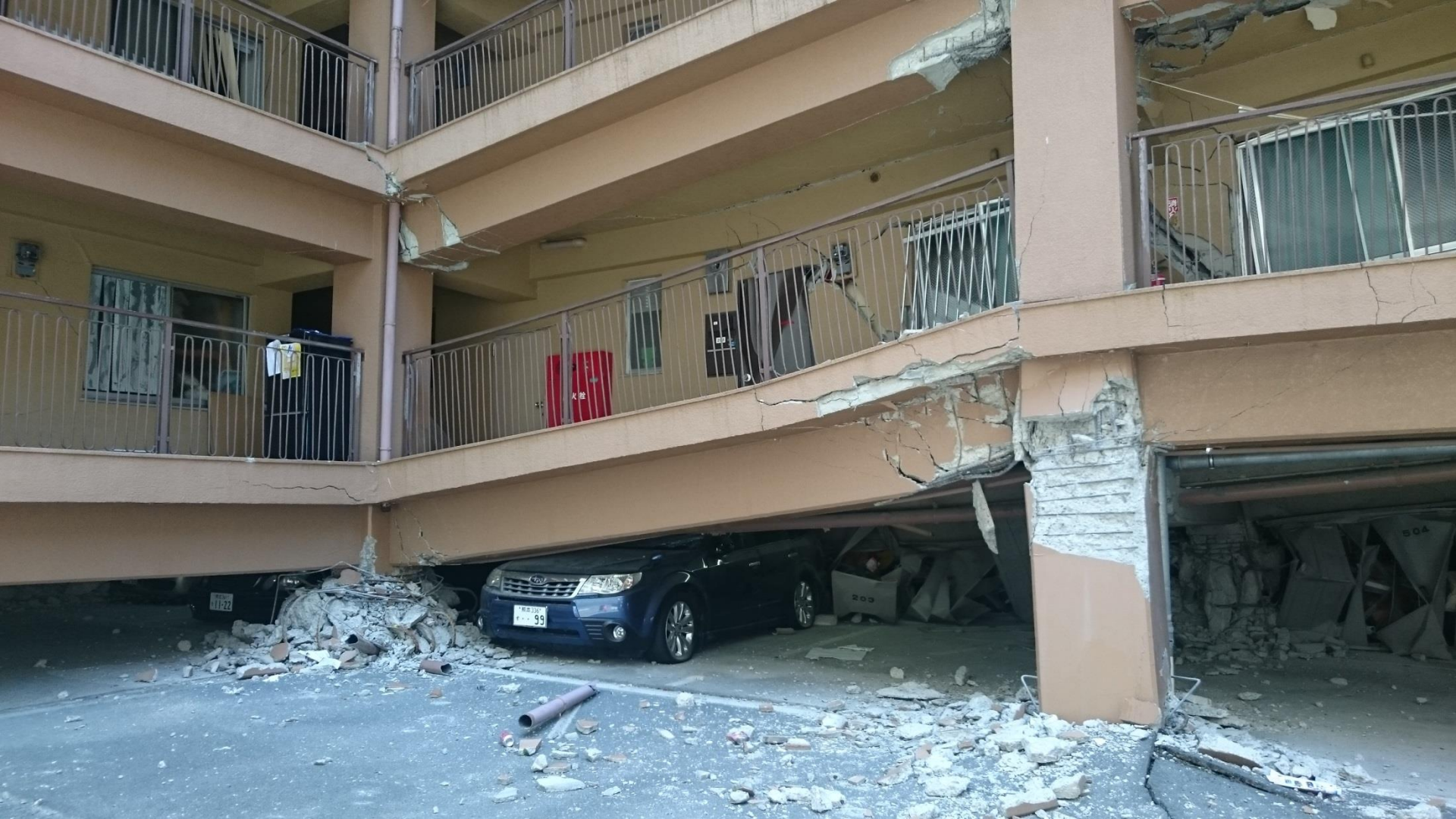
ピロティが潰れ、自動車が出敷きに H28:5:6 跡見学園女子大学 鍵屋撮影
