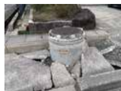
マンホールの浮き上がり
