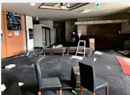
輪島市の大破したRC造8階建てホテルの1階ロビー。床が大きく湾曲して隆起している。大浴場に入っていたお客さんたちに浴衣を何枚も重ね着させて近くの警察署に避難させた。
