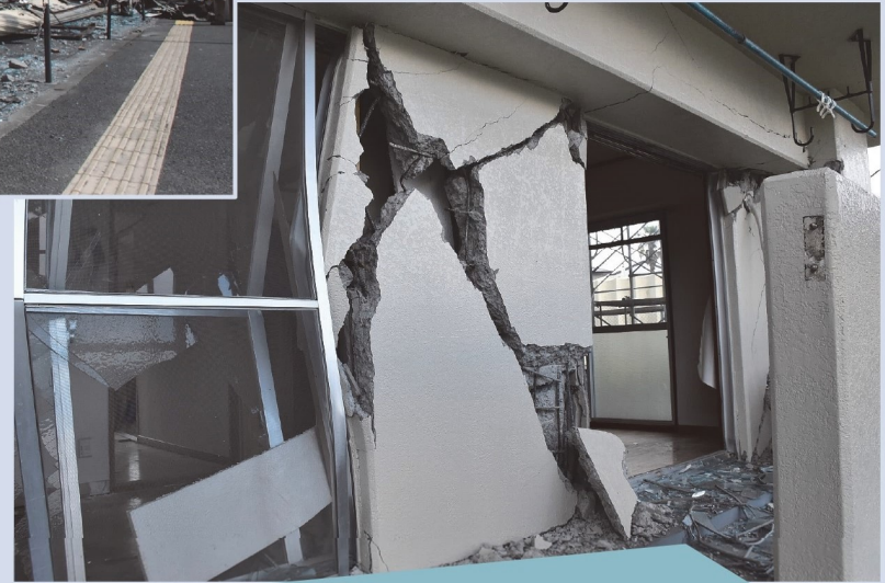
バルコニー側の鉄筋コンクリート造の壁が大破したマンション 写真提供者：JASO
