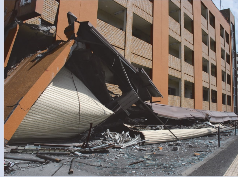
1階部分が層崩壊したマンション 写真提供者：JASO
