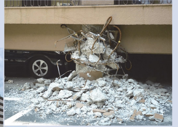
1階の駐車場（ピロティ）の柱が圧壊したマンション 写真出典：熊本災害デジタルアーカイブ/提供者：福島県白河市
